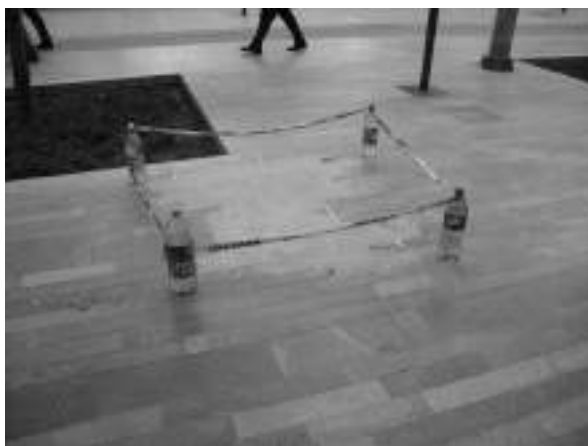
Reparación del pavimento de la Alameda, del lado colindante con el Palacio de Bellas Artes, septiembre de 2014.
