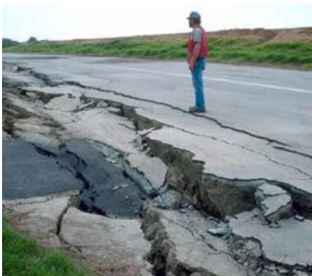
Foto 3. Agrietamiento del pavimento por licuación de arenas [17]
