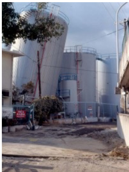
Foto 5. Asentamiento diferencial en tanque petrolero producto de licuación de arenas sueltas ante un evento sísmico [17]
