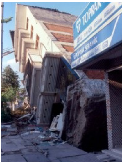
Foto 4. Volcamiento de edificio en Turquía por licuación de arenas y pérdida de capacidad de soporte del suelo de cimentación [17]
