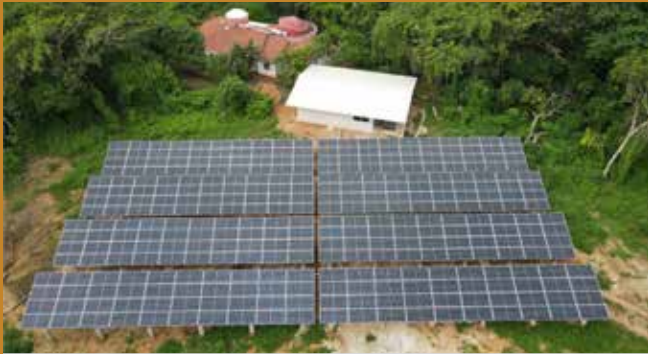
Parque Solar 1. UNPA. Campus Tuxtepec.
