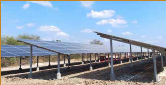
Vista parcial del Parque solar fotovoltaico. UNISTMO. Campus Ixtepec
