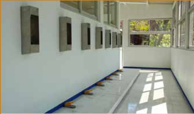
Vista parcial del área de Dispensadores de agua. H2O. UMAR, Campus Huatulco
