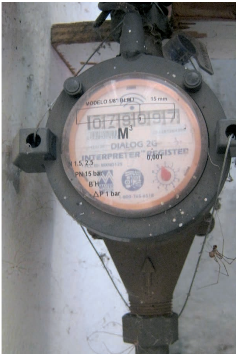
Medidor de agua, Puente Blanco, Iztapalapa.
