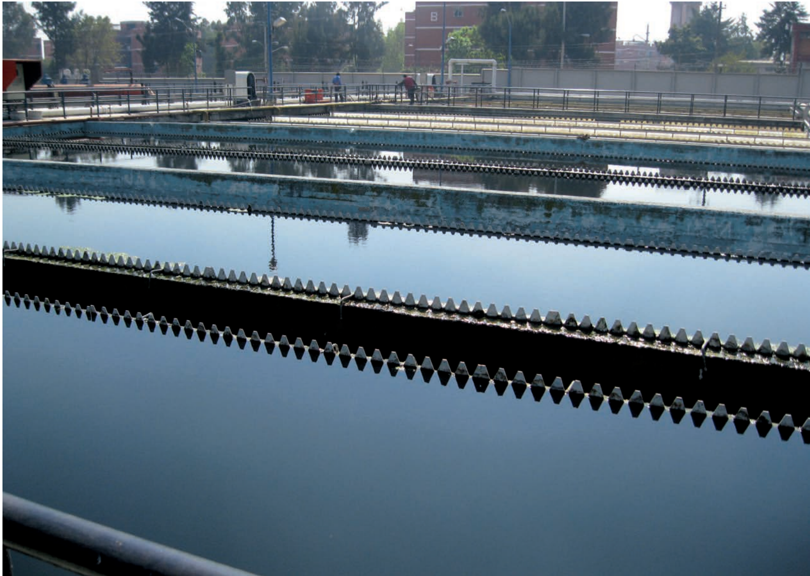
Planta de Tratamiento Cerro de la Estrella, Iztapalapa.
