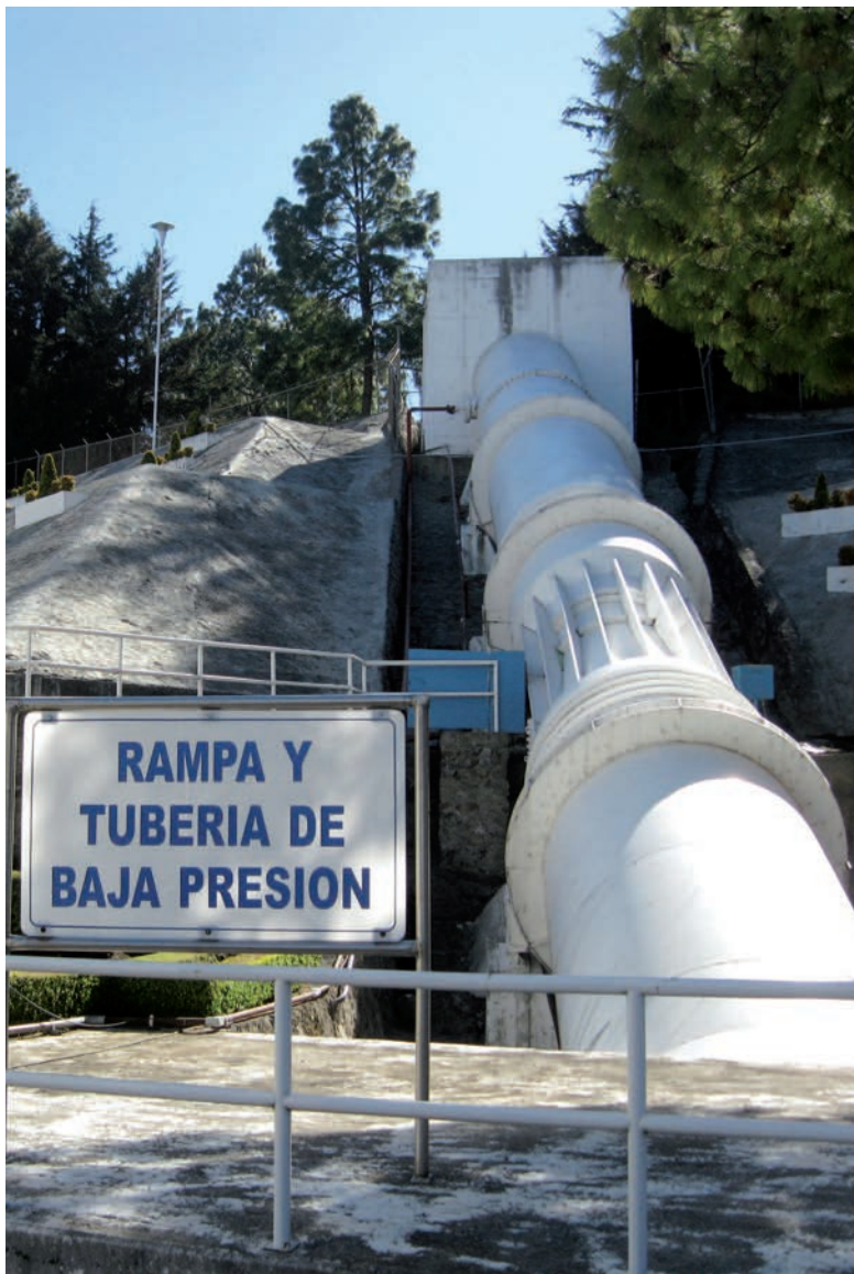
Planta de bombeo, Sistema Cutzamala.
