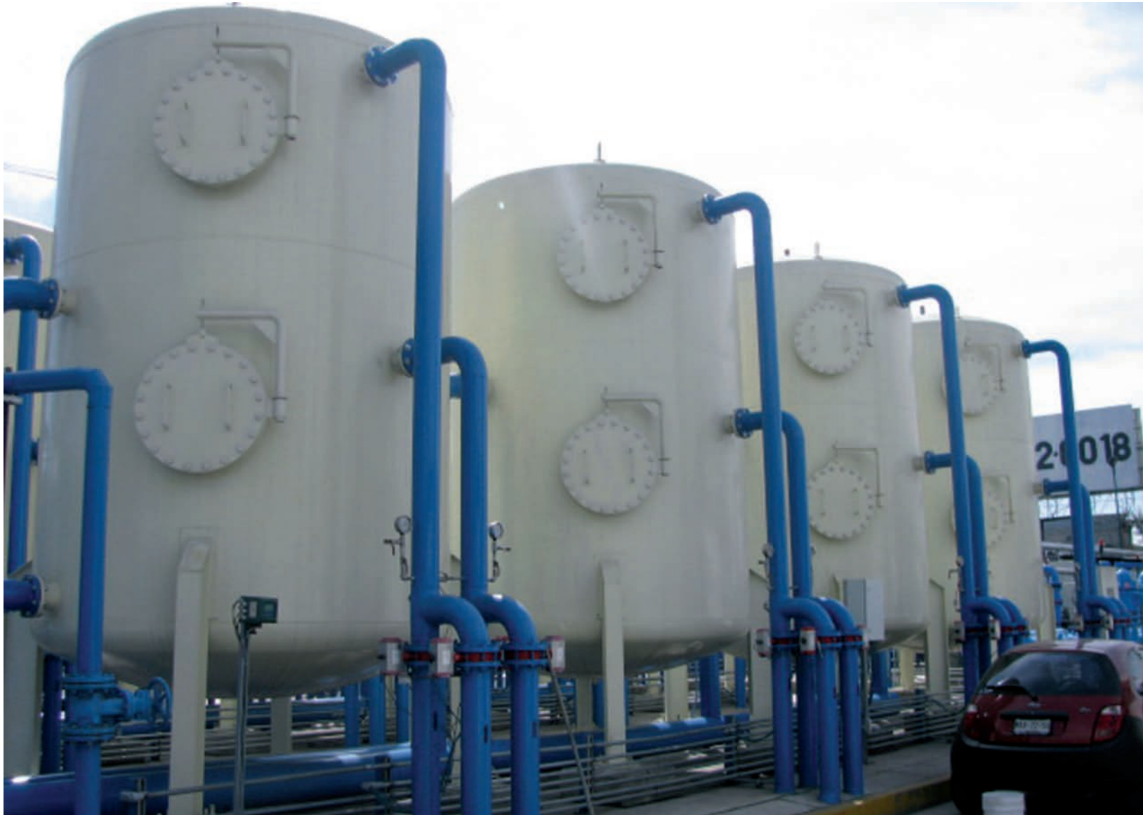
Planta potabilizadora de Santa Catarina, Iztapalapa.
