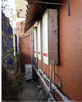
Vista de los tres inversores
