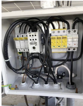
Caja de Combinación: Dispositivos de seguridad
