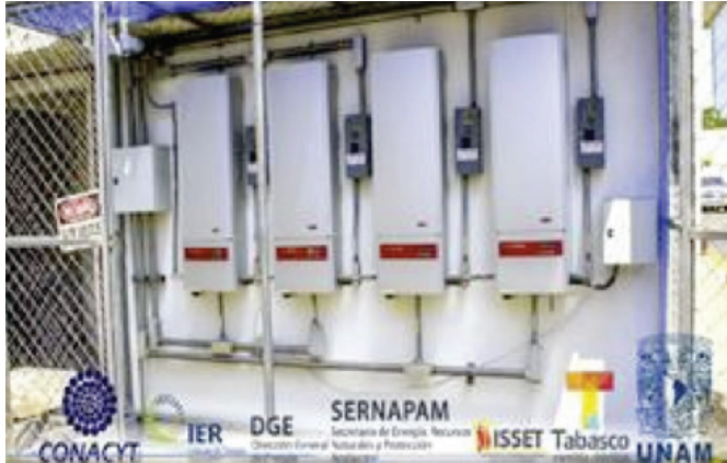
Vista de los 4 inversores de 11.4 kW
