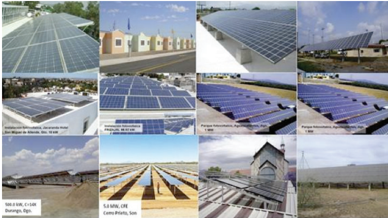
Figura 1.9: Conjunto de fotografías de sistemas FV´s instalados y en operación a lo largo de la República Mexicana (Fotos cortesía de varios colaboradores).
