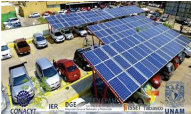
Vista aérea de los 4 Arreglos FV, cada uno de 11.25 kW
