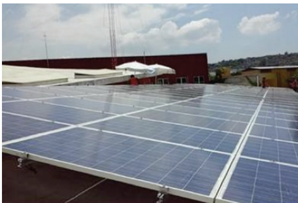
Vista de los módulos fotovoltaicos
