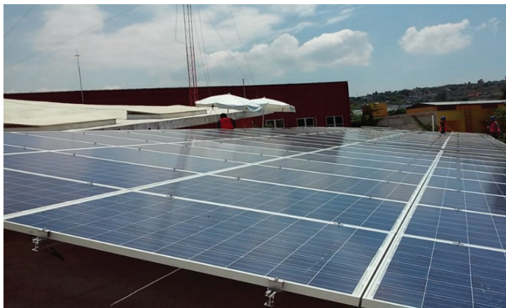
Figura 7.8: Sistema fotovoltaico interconectado a la red en las instalaciones del CeMIAgro.
