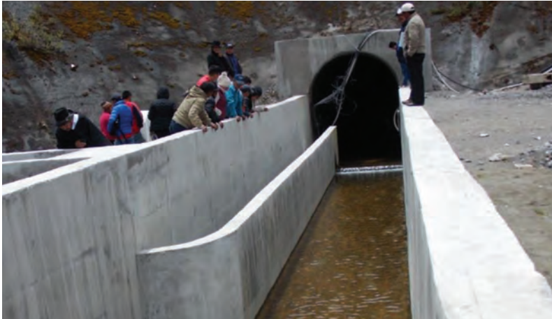
Figura 26 Repartidor de caudal a la salida del túnel cerca de Pesillo, (el de la izquierda para el PPI y el de la derecha para el canal de riego Cayambe-Pedro Moncayo)
