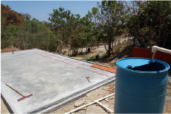
Figura 6-XIV Vista de la base el reactor y distribuidor de entrada de agua residual.
