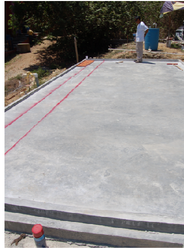
Figura 6-XV Vista de la base el reactor y distribuidor de salida del agua desinfectada.
