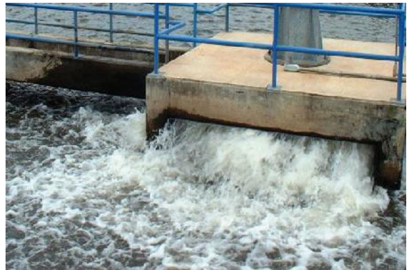
Foto 9. Planta de Tratamiento de Aguas Residuales de Tehuantepec. Fuente: Captura propia. Julio, 2012
